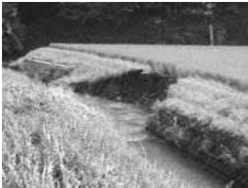
町内被害状況
