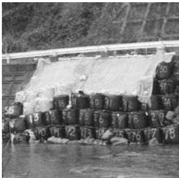
災害現場(野上川下流)
