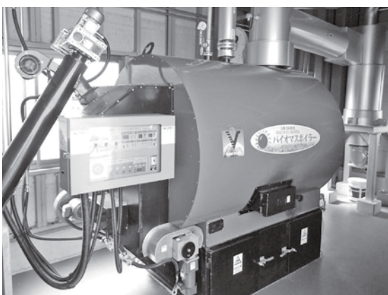
今回整備された紙おむつペレット専用ボイラー
