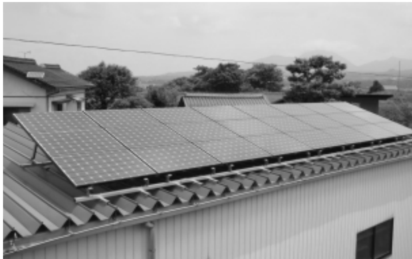
太陽光発電システム
