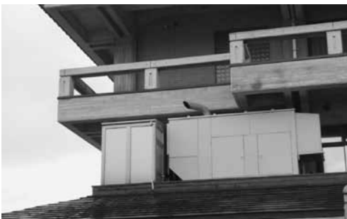
本庁舎2階ベランダに設置されている発電装置
