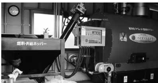
ペレットボイラー
