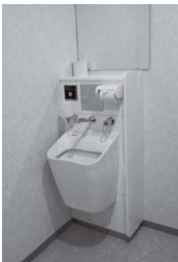
溝口公民館に設置されたオストメイト
