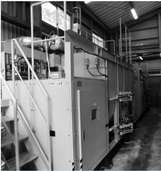
管理センターのペレット再生機
